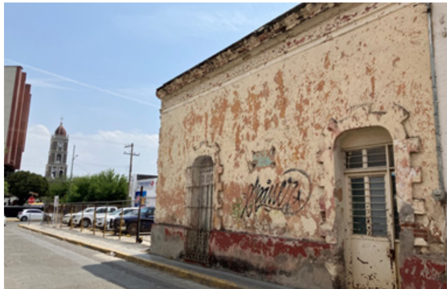
Solar Baldío donde se ubicaba la casa que sirvió de recinto oficial del Poder Legislativo de 1867 a 1879.
